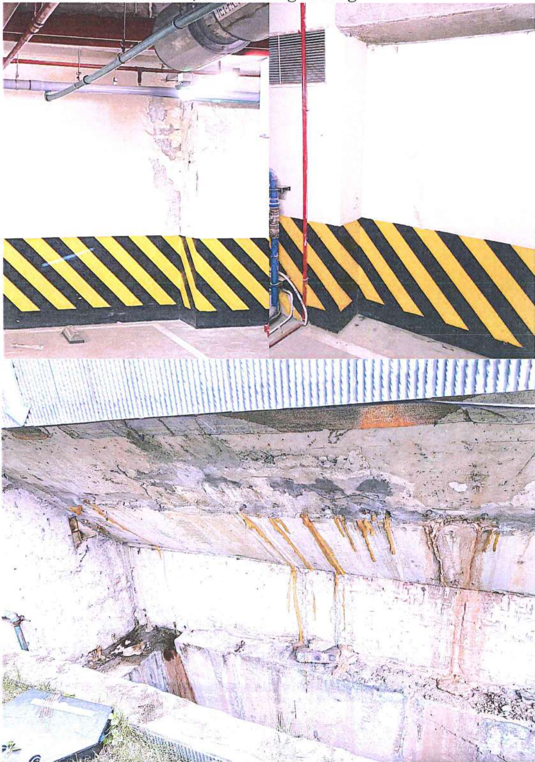
Vị trí nứt tường bê tông
